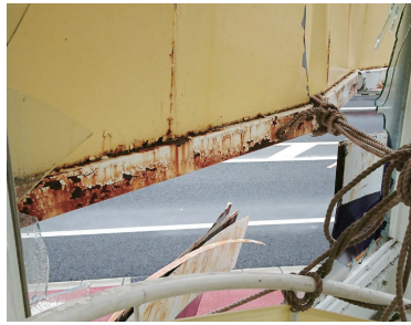
看板が外れ、窓ガラスを直撃
